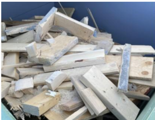
Bois Q1 contaminé par béton
